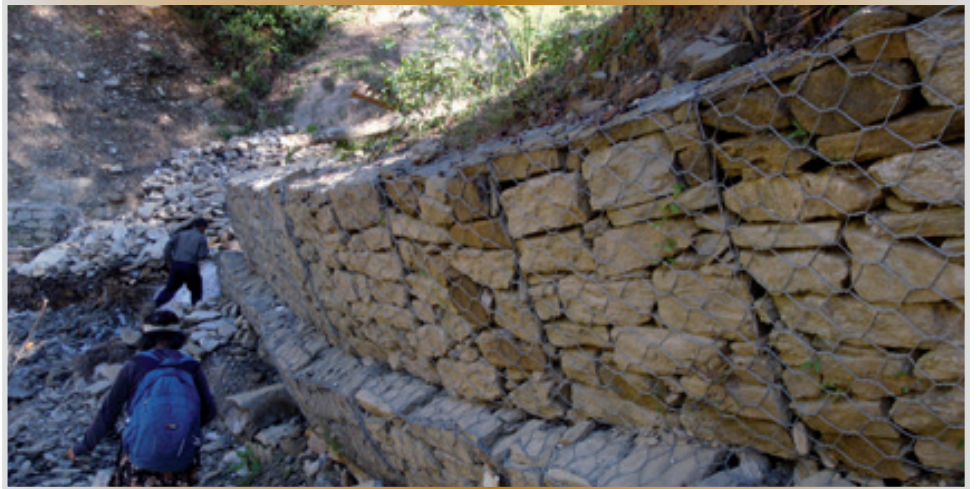
चित्र १४ : दोलखा जिल्लामा निर्माण गरेको ६ महिनामा ढल्किएको तारजाली छेकबार, फोटो : K. sudmeier-Rieux, २०१०
