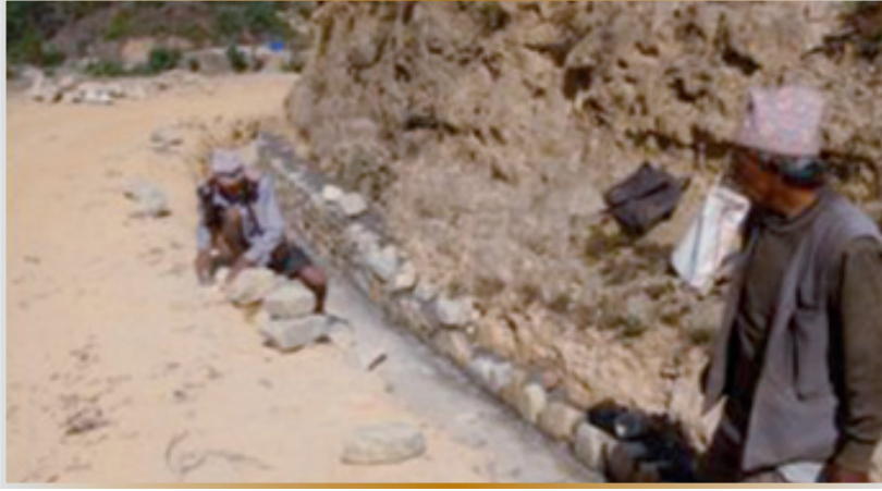
चित्र १३क: सडक किनारमा सिमेन्ट प्रयोग गरी निर्माणाधिन ढुङ्गाको पक्की नाला । फोटो: सञ्जय देवकोटा, २०१४ ।
