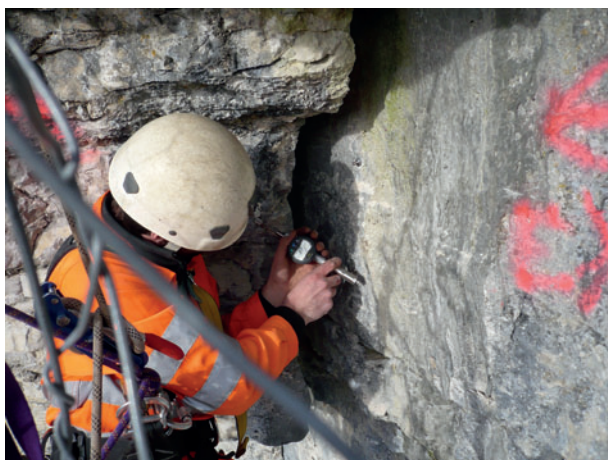
Figure 12.—Pose d'un fissuromètre (Bolozon); photo BG / Hugues Foltzer.
