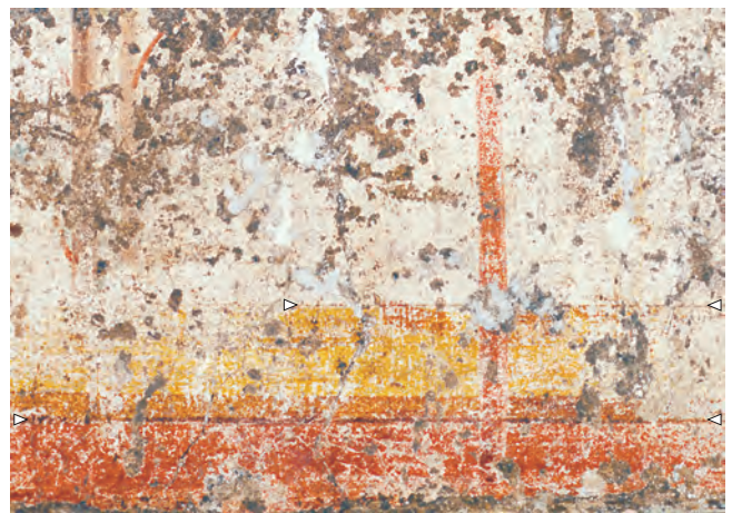
Abb. 129: Meikirch - Kirche 1977. Kryptoportikus 15, Bildtafel 11. Vorzeichnungen (Abdrücke der Schlagschur) am Rand der Sitzbank, auf der Höhe der Simsimitation unterhalb der mittleren Wandzone.
