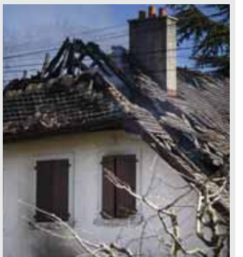
L'état de la maison, jeudi. Des traces d'accélérateur ont été trouvées à l'intérieur. KEYSTONE
